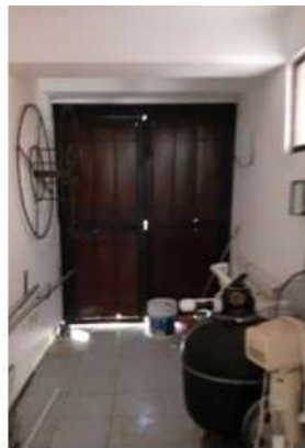
CUARTO DE MÁQUINAS
