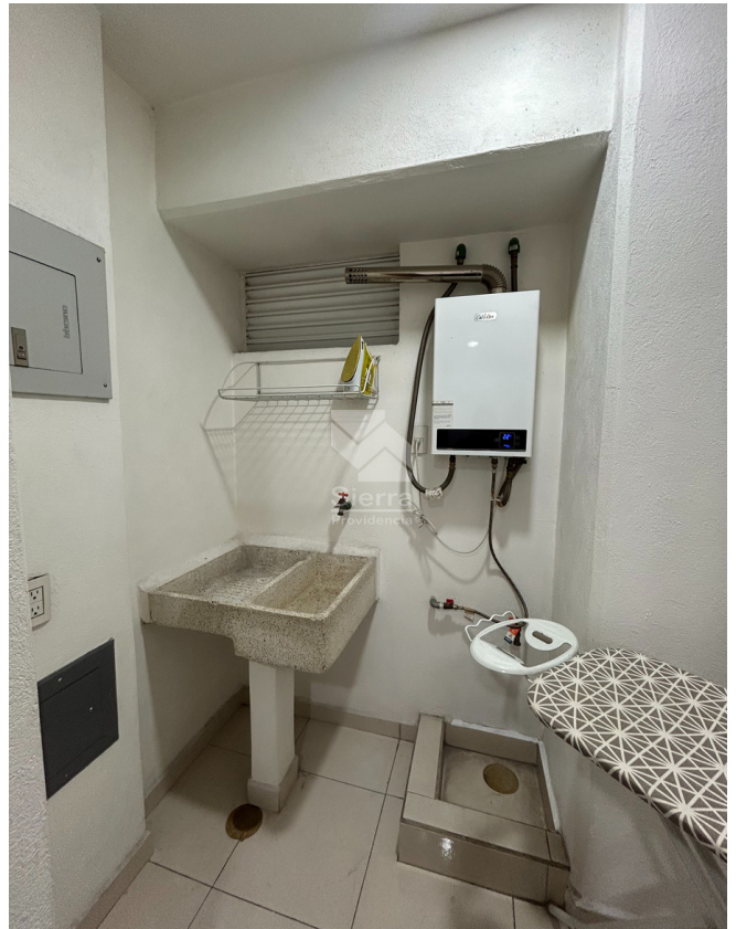
CUARTO DE LAVADO
