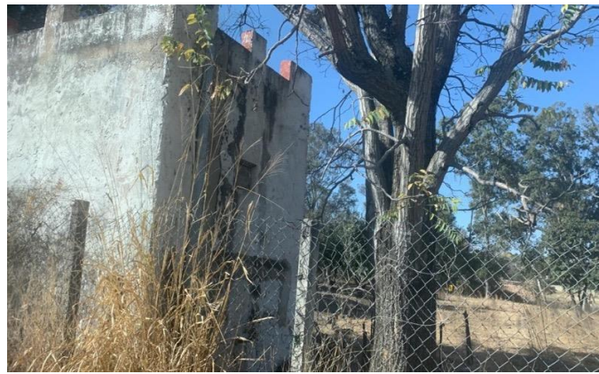
Depósito con tanque
