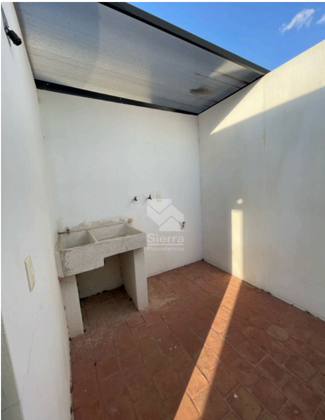
Cuarto de lavado
