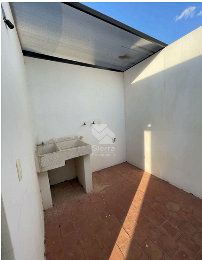
Cuarto de lavado
