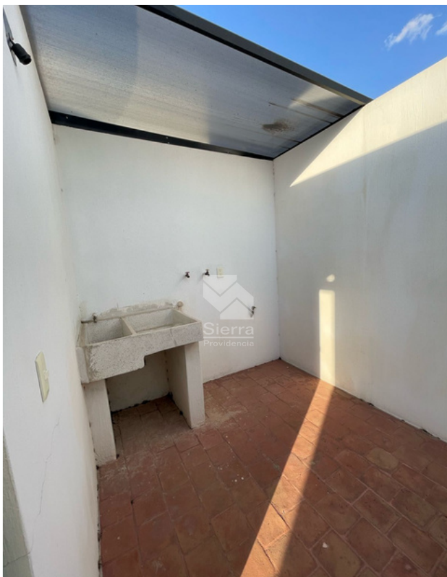
Cuarto de lavado
