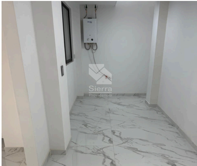
Cuarto de lavado
