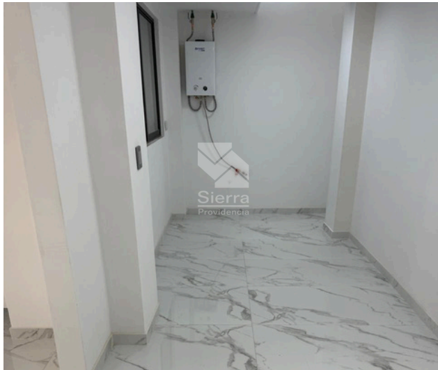
Cuarto de lavado
