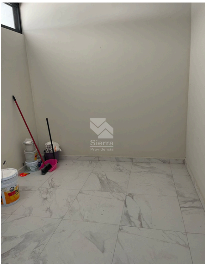
Cuarto de lavado
