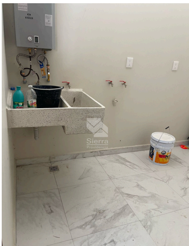
Cuarto de lavado
