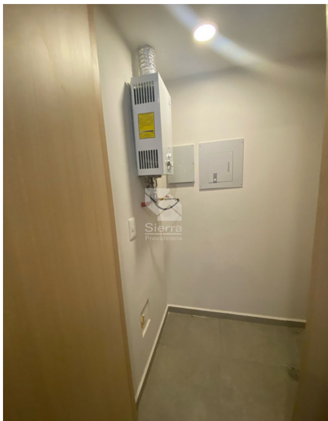
Cuarto de lavado
