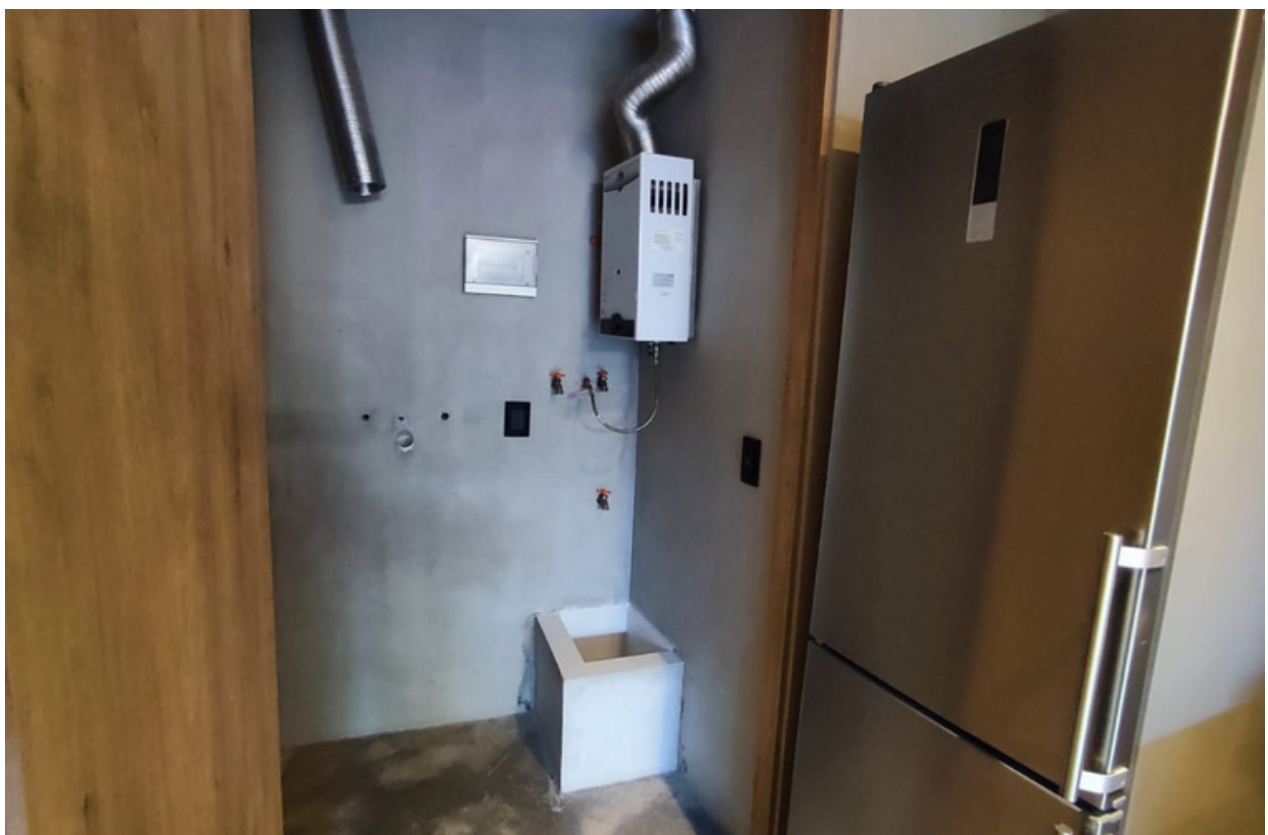
Cuarto de lavado
