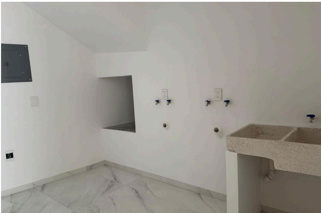
Cuarto de lavado
