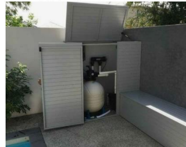
Caseta de equipos de piscina en restricción posterior, sin rebasar altura de barda.
