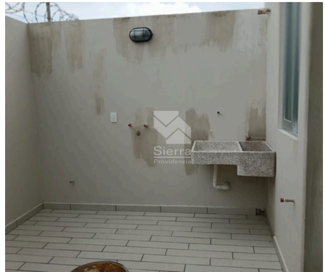
Cuarto de lavado
