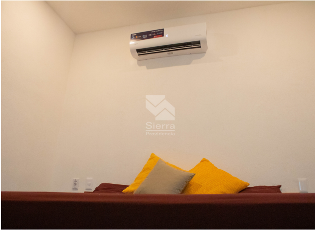
Aire acondicionado en habitación
