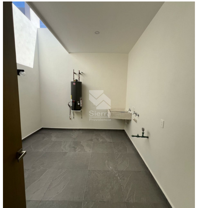
Cuarto de lavado
