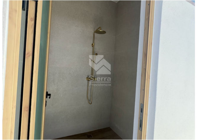
Cuarto de lavado
