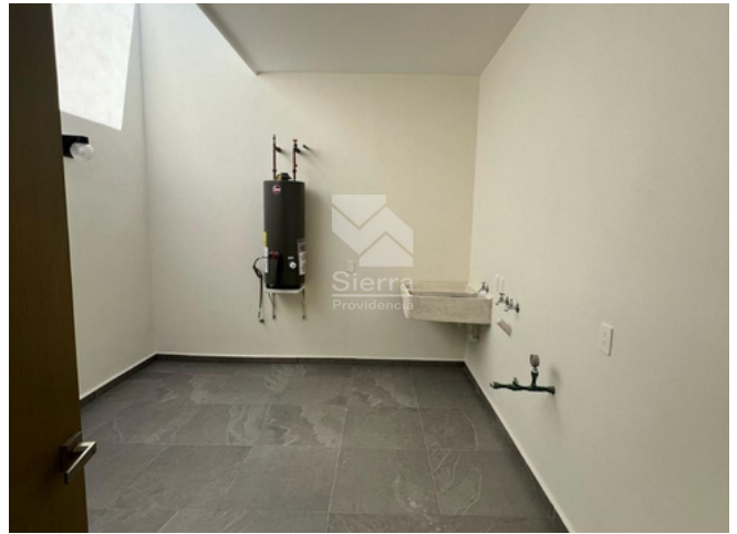
Cuarto de lavado
