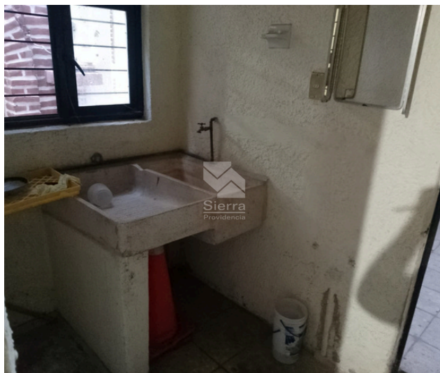
Cuarto de lavado
