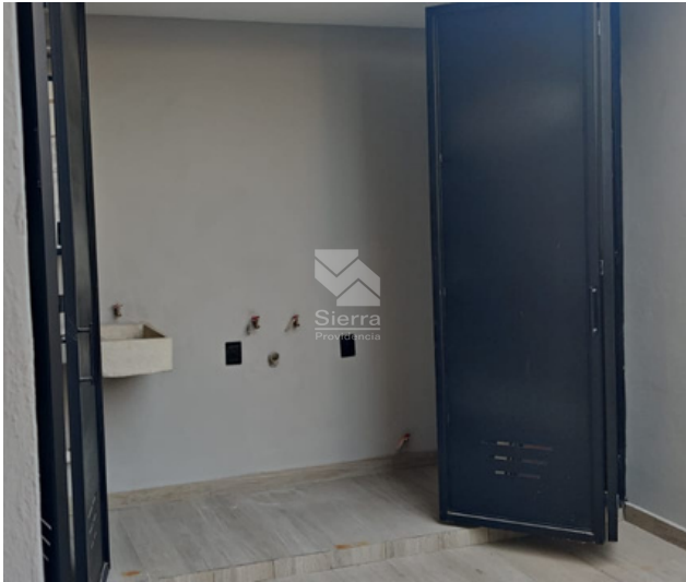
Cuarto de lavado
