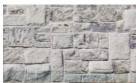
Cantera local chapa rústica color gris en muro de alberca y fachada
