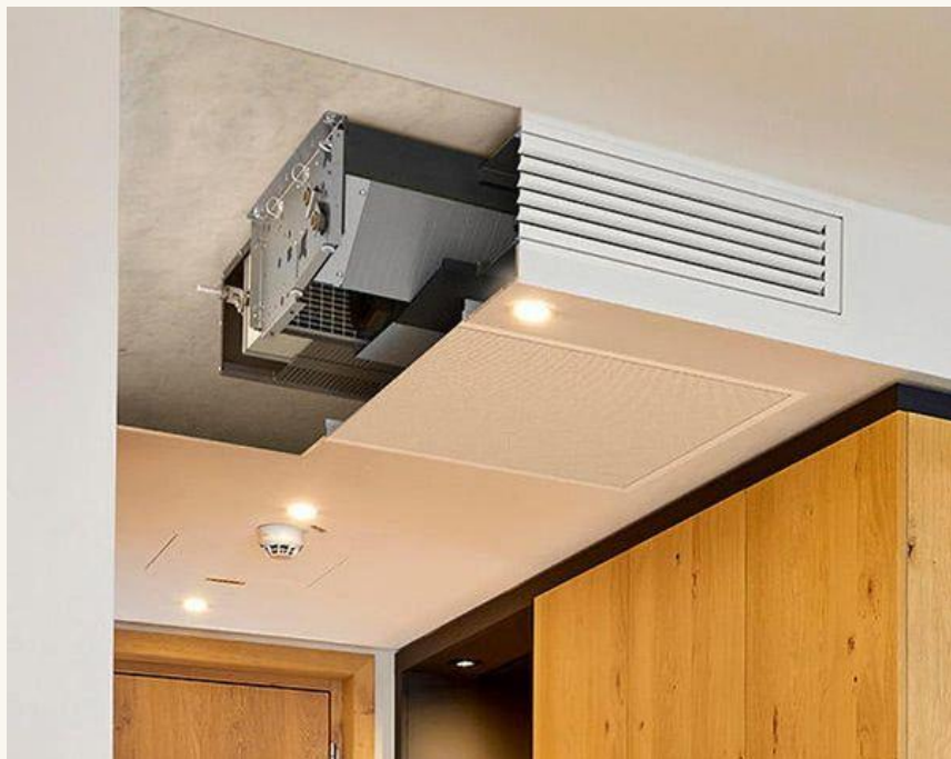
Sistema Fan and Coil En sala, comedor (áreas comunes)
