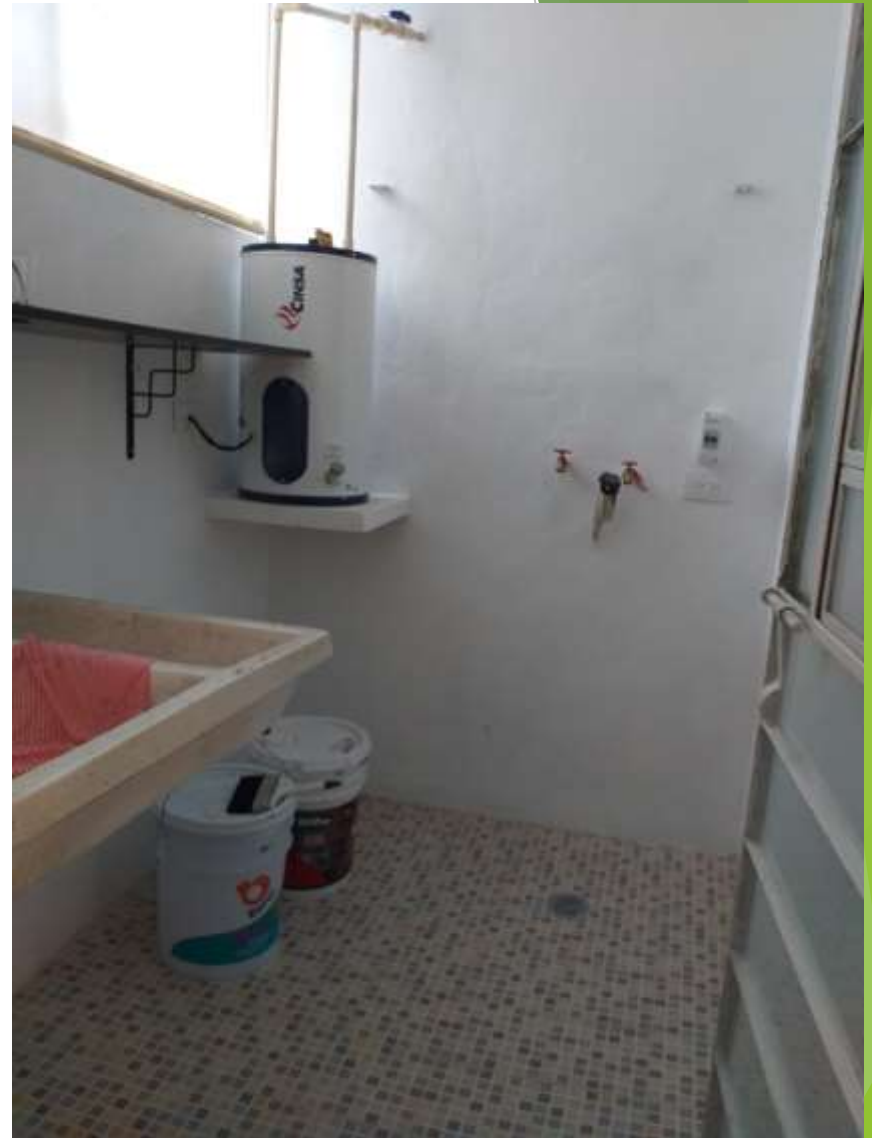
Cuarto de Lavado
